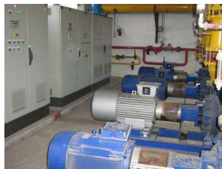
Pompes d'alimentation en eau réfrigérée
